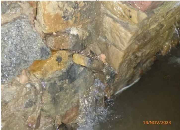
Bild 3: Starker Wasseraustritt an den Natursteinen Segmente 1 - 3
